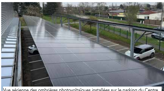
Vue aérienne des ombrières photovoltaïques installées sur le parking du Centre Omnisports : 476 panneaux solaires au service de la transition énergétique
