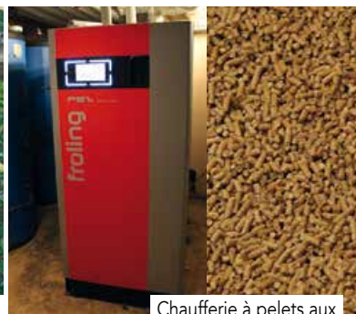
Chaufferie à pellets aux ateliers municipaux
