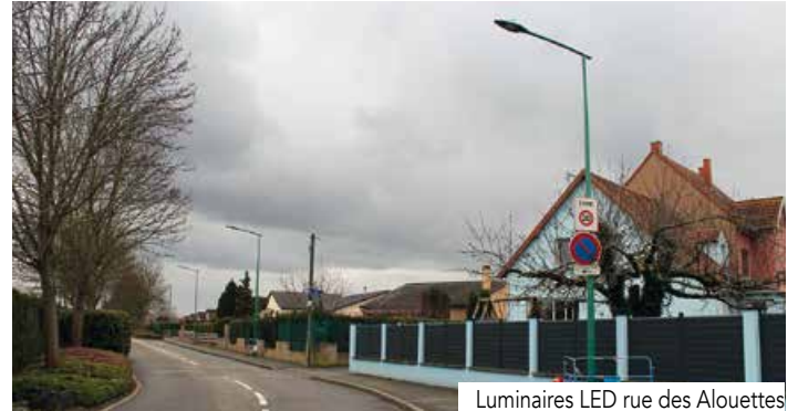
Luminaires LED rue des Alouettes
