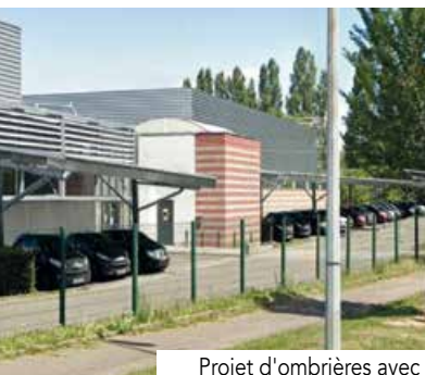
Projet d'ombrières avec panneaux photovoltaïques
